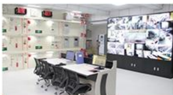
消防监控实训室
